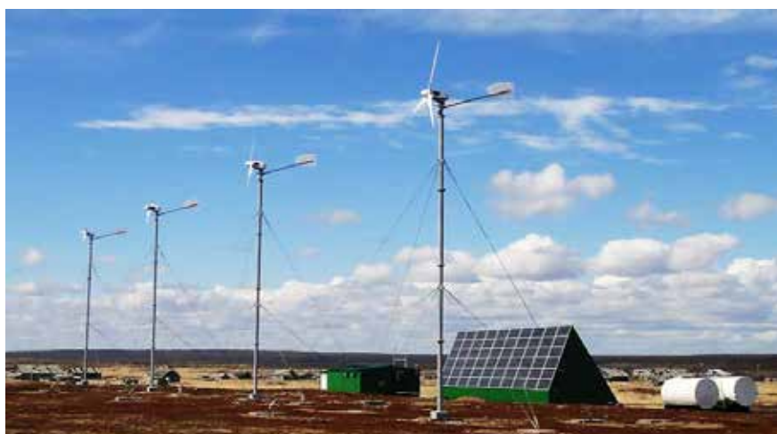
Рис. 3. Ветросолнечно-дизельная электростанция в Пялице
