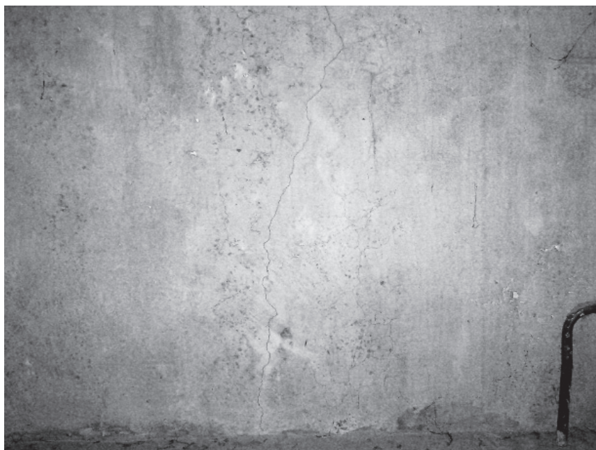
Рис. 4. Вертикальная трещина в керамзитобетонной панели технического этажа. Панель расположена по оси «Е»/«8–9» (дом № 1). Ширина раскрытия менее 1 мм
