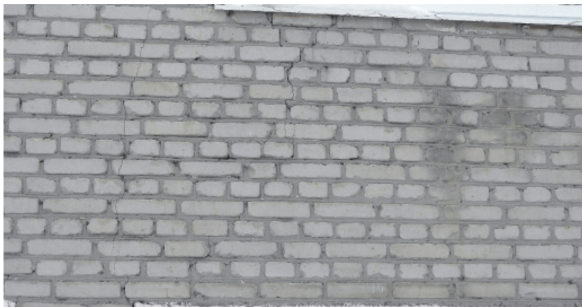
Рис. 1. Трещины с шириной раскрытия более 5 мм
