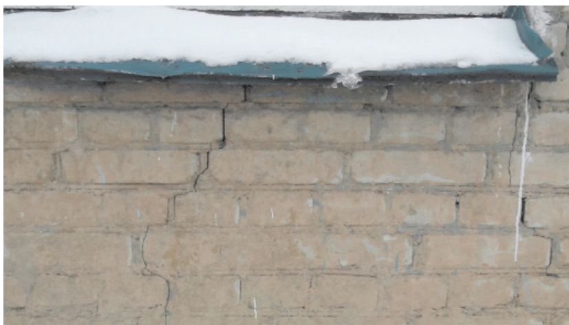
Рис. 2. Трещины в цокольной части здания с шириной раскрытия более 5 мм
