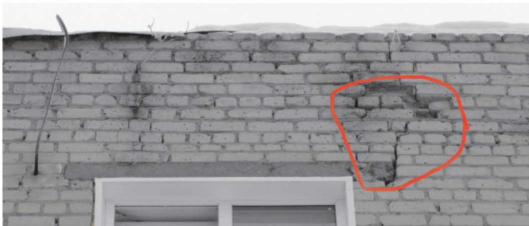
Рис. 4. Выпадение кирпичной кладки (обведено красным)
