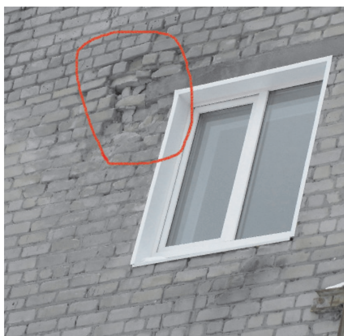
Рис. 5. Выпадение кирпичной кладки (обведено красным)
