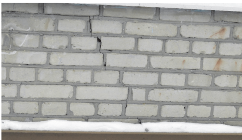
Рис. 3. Трещины в цокольной части здания с шириной раскрытия более 5 мм
