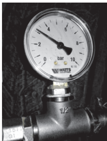
Рис. 1. Показание манометра при подключении к стационарной системе водоснабжения
