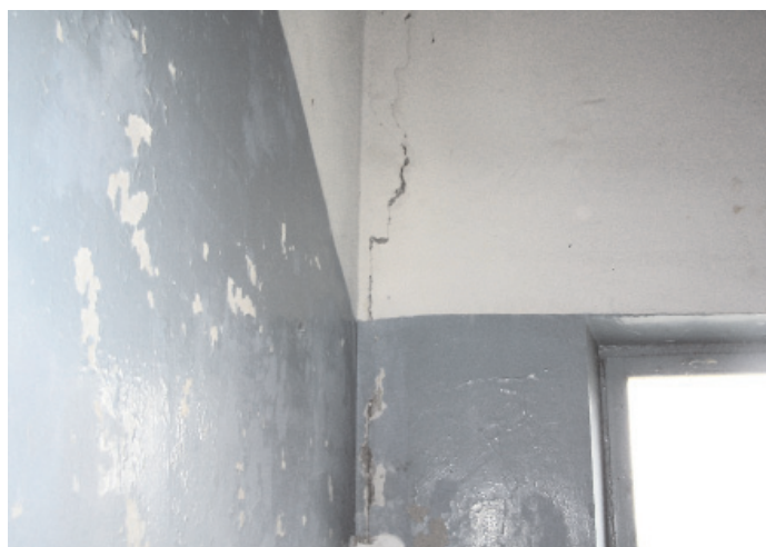
Рис. 3. Вертикальная трещина в стыке керамзитобетонной и железобетонной панелей 9 этажа по оси «4»/«Д» (дом № 1). Ширина раскрытия 2 мм
