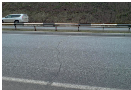
Рис. 5. Морозобойная трещина в середине выемки
