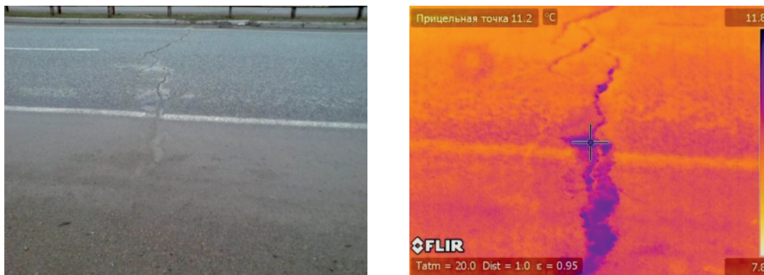
Рис. 4. Вид и термограмма трещины на участке насыпь – выемка
