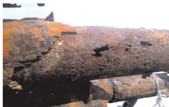
Рис. 1. Сквозная коррозия элементов ОБ МСП
