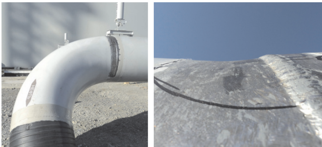
Рис. 1. Стык трубопровода приемо-раздаточного патрубка ПРП-900 резервуара РВС-100000 с дефектом типа «вмятина»
