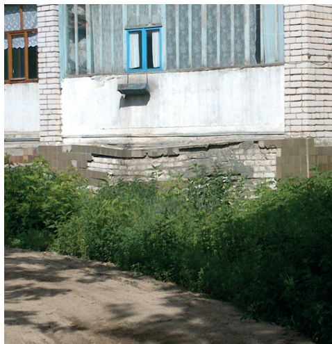
Рис. 1. Деформация жилого дома
