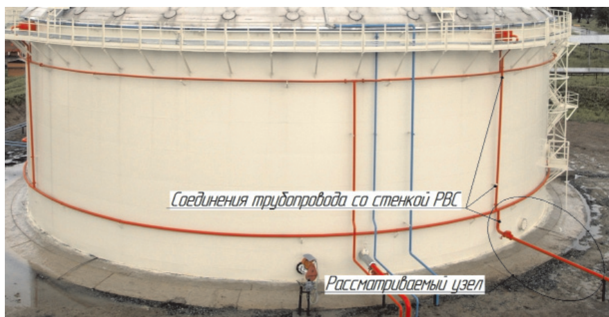
Рис. 1. Общий вид узла подключения трубопровода пожаротушения к РВС-20000
