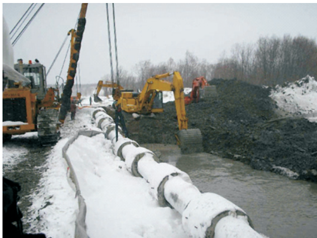
Рис. 1. Река Ай – строительство перехода нефтегазопровода, рытье траншеи, 2006 год (Источник: официальный сайт «Сахалин Энерджи» www.sakhalinenergy.com )
